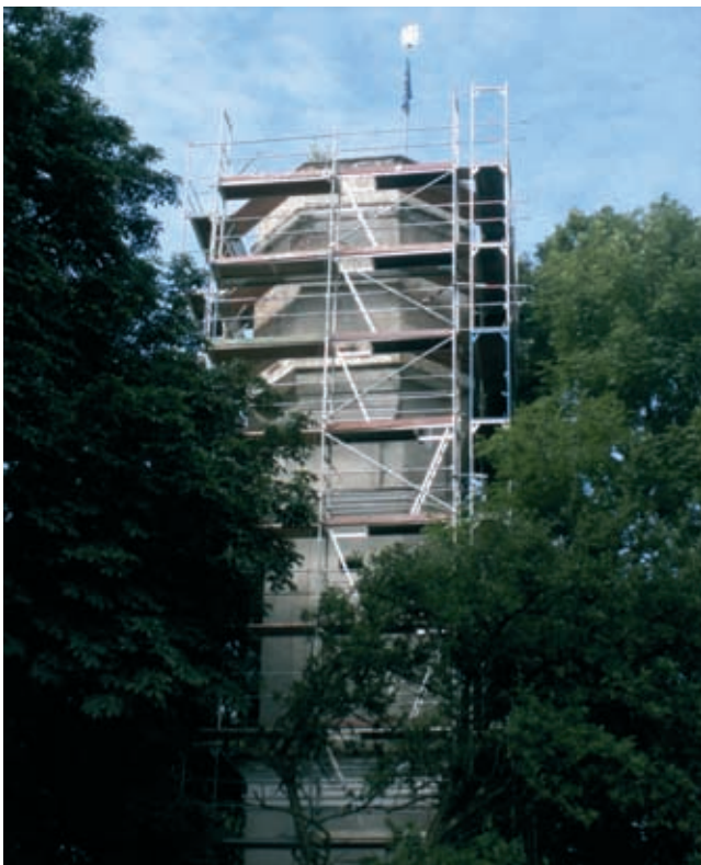
Der historische Wasserturm bedarf dringend der Sanierung.
